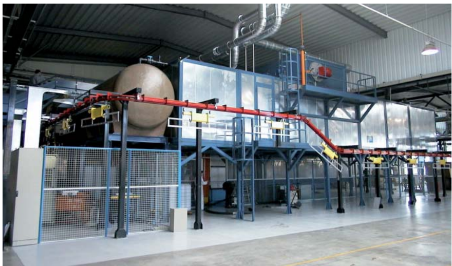
Piec suszący i zbiornik akumulacyjny.
