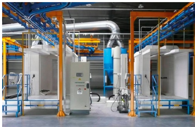
Kabiny dielektryczne ze stanowiskami ręcznymi wyniesionymi.
